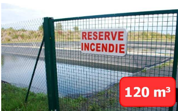
Réservoirs à l'air libre sur sites industriels
